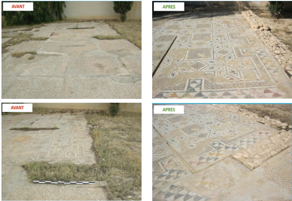
Fig. 1. Travaux de consolidation des mosaïques et drainage des eaux à El Jem (Photo : L. Belhouchet)
