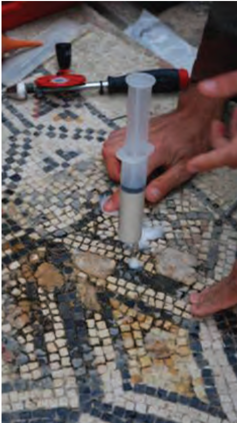
Fig.16. Décollement: remplissage de la cavité (cliché : Mouidi Hani)
