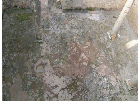
Fig. 17. Etat du pavement avant intervention (cliché : Mouidi Hani)
